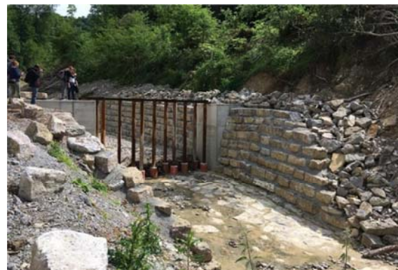
Abbildung 14: Geröllfang zum Schutz der Unterlieger vor von Wassermassen mitgeführtem Gestein etc.
