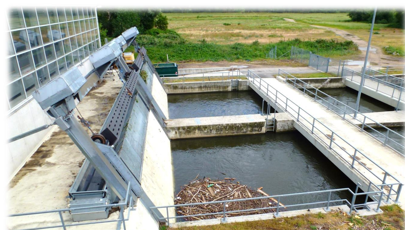
Durchflusseinlass der Wasserkraftanlage mit vorgeschalteter Rechenanlage
