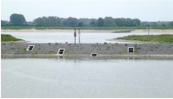
Abbildung 5: Zufuss in die Flutrinne per Sielanlage
