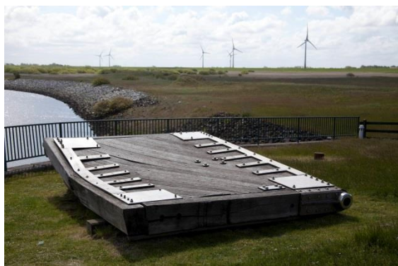
Abbildung 3: Zerstörte Schütztafel des Holmer Siels
