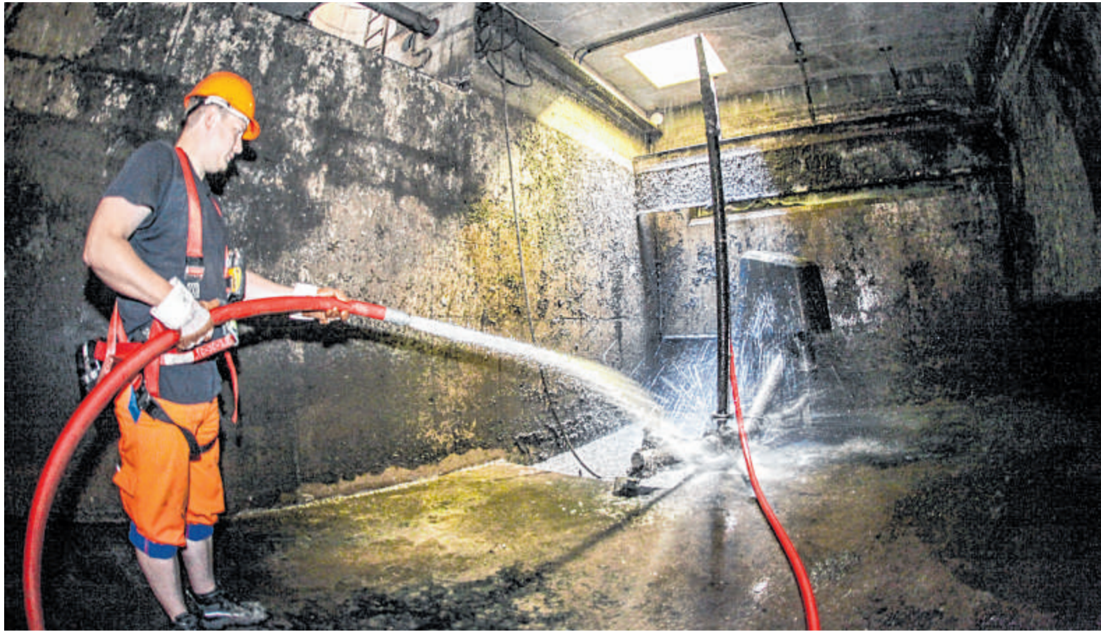
ESI-Mitarbeiter Niklas Ohm befreit den Wirbeljet vom Schlick und dem, was sonst noch so in der Kanalisation ist. Die Männer können in den Regenrückhaltebecken meist nur nach längeren Trockenperioden arbeiten.
