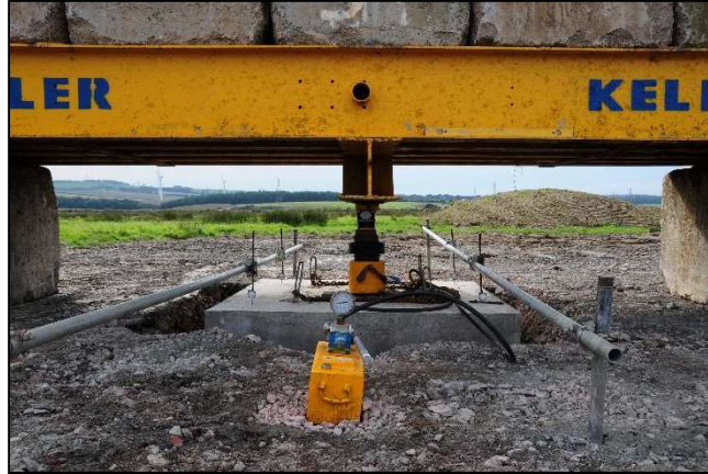
Abbildung 4-2: Blick auf die statische Probelastung auf einer Fläche von 2 m x 2 m mit einer Probelastung von 300 kPa, was der zweifachen Gebrauchslast entspricht.
