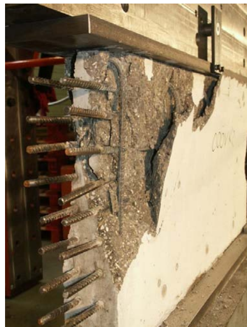
Bild A.2-22. Bruchbild der Scheibe 000VK1 (Ansicht Ost) Fig. A.2-22. Panel 000VK1 at failure (view east)
