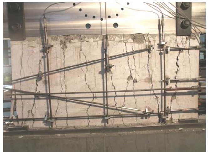
Bild A.1-41. Bruchbild der Scheibe 250T (Ansicht Süd) Fig. A.1-41. Panel 250T at failure (view south)
