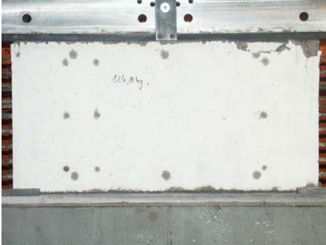
Bild A.4-59. Bruchbild der Scheibe F000VK4 (Ansicht Nord) Fig. A.4-59. Panel F000VK4 at failure (view north)
