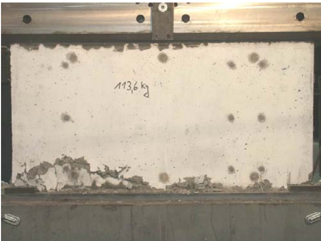
Bild A.4-56. Bruchbild der Scheibe FVK2 (Ansicht Süd) Fig. A.4-56. Panel FVK2 at failure (view south)
