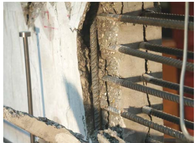
Bild A.1-33. Bruchbild der Scheibe 075T (Ansicht Nordwest) Fig. A.1-33. Panel 075T at failure (view north-west)
