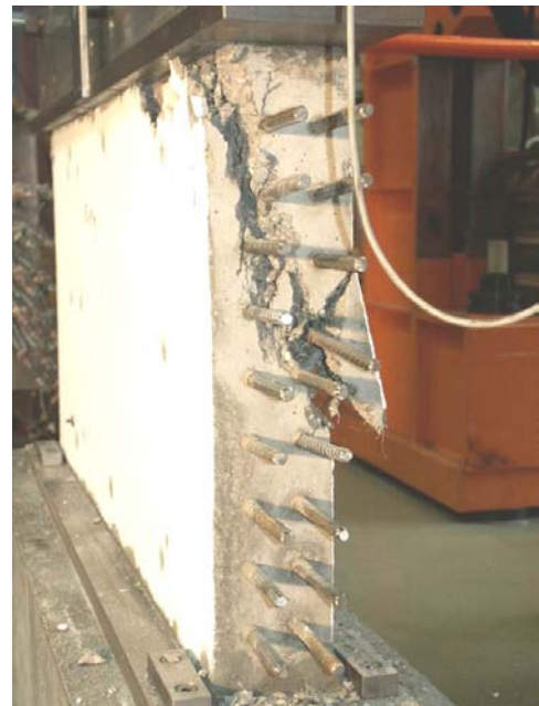
Bild A.4-60. Bruchbild der Scheibe F000VK4 (Ansicht West) Fig. A.4-60. Panel F000VK4 at failure (view west)
