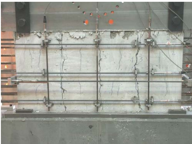
Bild A.1-80. Bruchbild der Scheibe F150T (Ansicht Nord) Fig. A.1-80. Panel F150T at failure (view north)
