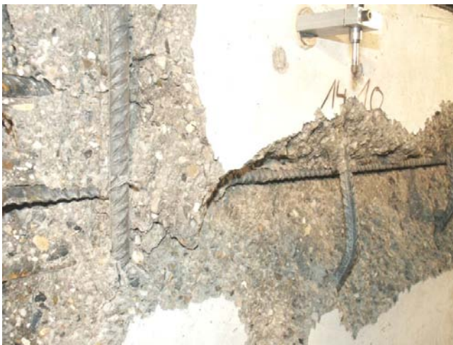
Bild A.2-26. Bruchbild der Scheibe 000VK2 (Ansicht Nord) Fig. A.2-26. Panel 000VK2 at failure (view north)
