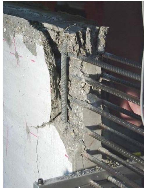
Bild A.1-3. Bruchbild der Scheibe 000T (Ansicht Ost) Fig. A.1-3. Panel 000T at failure (view east)
