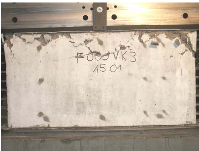
Bild A.3-10. Bruchbild der Scheibe F000VKT (Ansicht Süd) Fig. A.3-10. Panel F000VKT at failure (view south)
