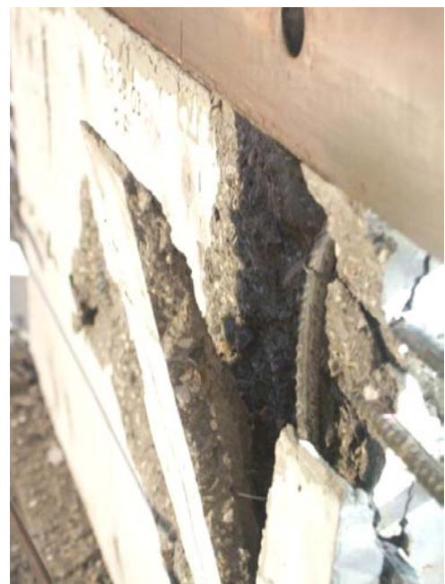
Bild A.1-103. Bruchbild der Scheibe 015 (Ansicht Nordwest) Fig. A.1-103. Panel 015 at failure (view north-west)
